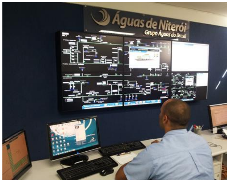
Figura 4.9: Centro de Controle Operacional CAN. Fonte: CAN
