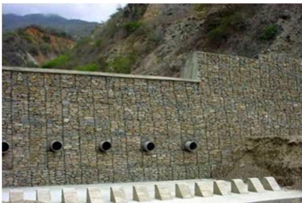
Figura 2.10 – Barreiras permeáveis – Muro de Gabião – Parque Waraira Repano (Ávila) Caracas, Venezuela.
