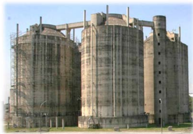
Figura 2.3: Digestores da ETE Alegria (CEDAE, 2012 apud Braz, 2012)
