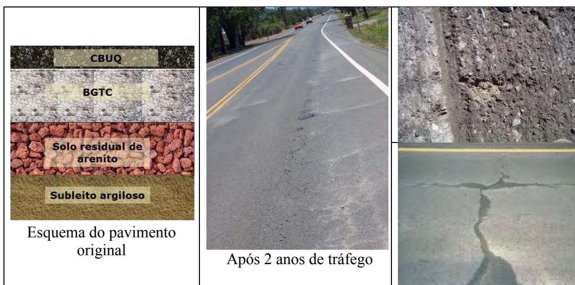
Figura 4.15: Pavimento semirrigido da Rodovia Porto Alegre – Osório na década de 1970 (Fonte: Washington Pérez, 2005 – Palestra)
