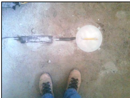
Célula de pressão no topo da sub-base
