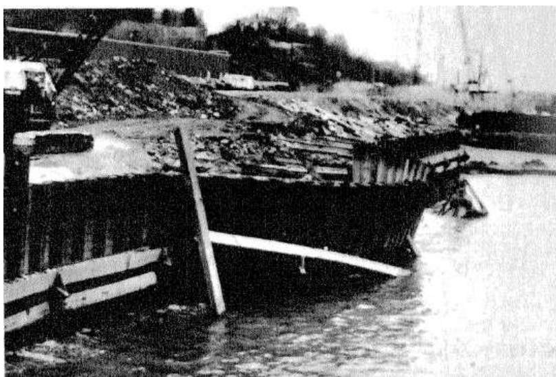
Figura III.6– Colapso da cortina de estacas prancha - LaGatta e Shields (1984)
