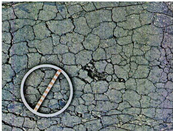
Figura 2.19 - Trincas de fadiga (tipo “couro-de-jacaré”) de alto nível de severidade (DNIT 005/2003).
