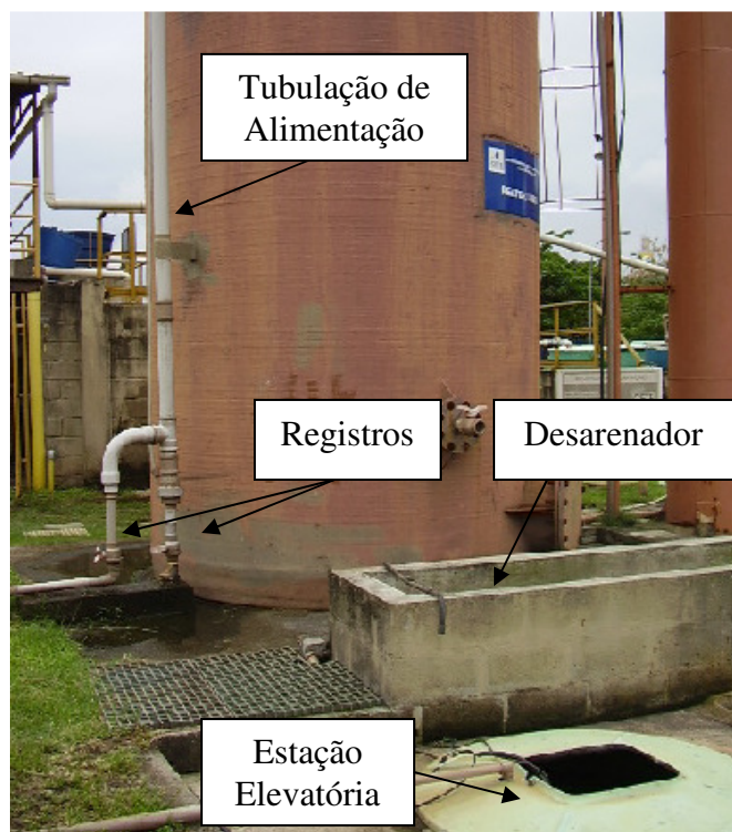
Figura 27 - Vista da estação elevatória e da tubulação de alimentação do reator UASB provida de registros para controle de vazão
