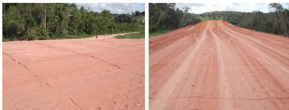
Figura 3.30-Trincas transversais no aterro próximo ao encontro da ponte na área do rio João de Tiba.
