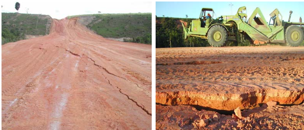
Figura 3.20- Ruptura na área do rio Camurugi.
