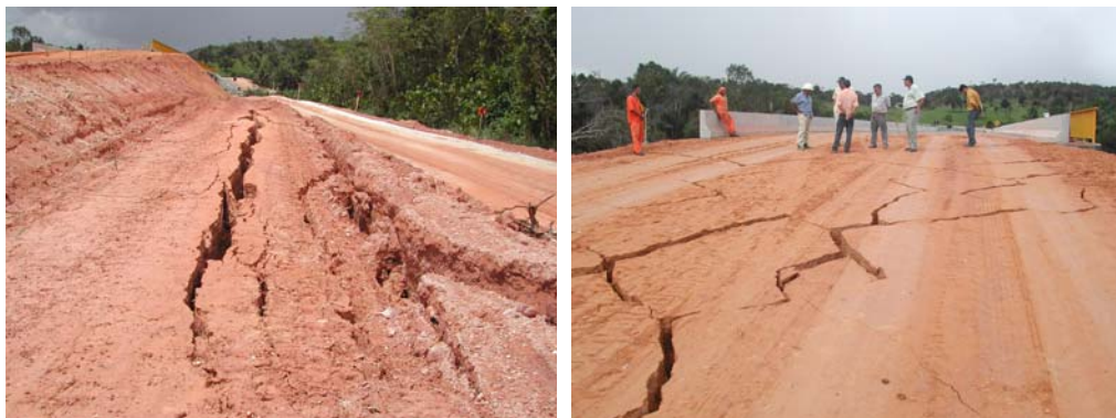
Figura 3.29- Ruptura do aterro próximo ao encontro da ponte na área do rio João de Tiba.
