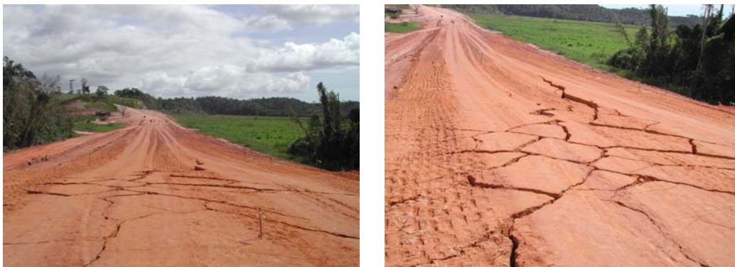
Figura 3.28- Ruptura do aterro já reforçado na área do rio João de Tiba.
