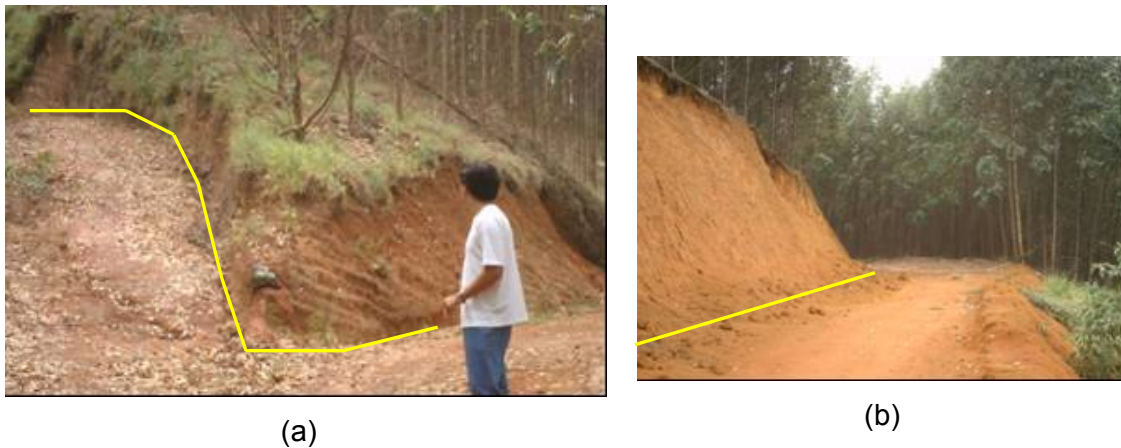
Figura 1-1 - Apresentação das canaletas de drenagem, que acabam perdendo sua função por encher-se de serrapilheira (a) e/ou de material escorregado dos taludes (b).
