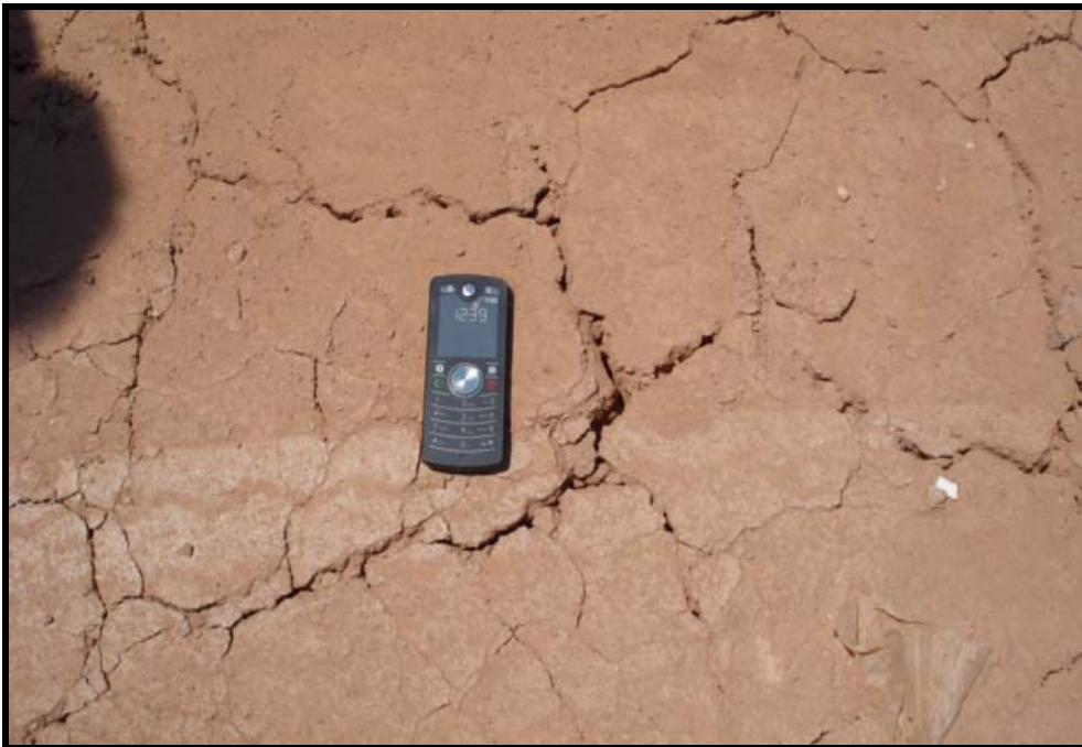
Figura 2.15 – A: Solo de Cobertura do aterro de Gramacho /RJ. Detalhes das trincas – contração da argila. Foto de 28 de agosto de 2007.
