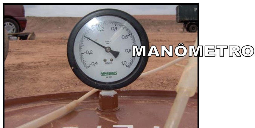
Figura 3.22: Manômetro instalado na placa.
