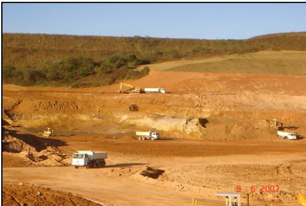
Figura B. 22- Mês de junho de 2006- Vista do dique sul, com escavações à jusante do I2 e PZC-2.
