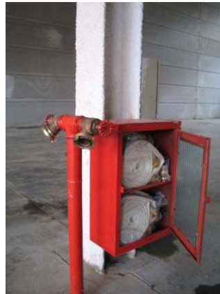
Figura 5.32 – Caixa de incêndio (água de aproveitamento pluvial) fonte: SMO, 2006
