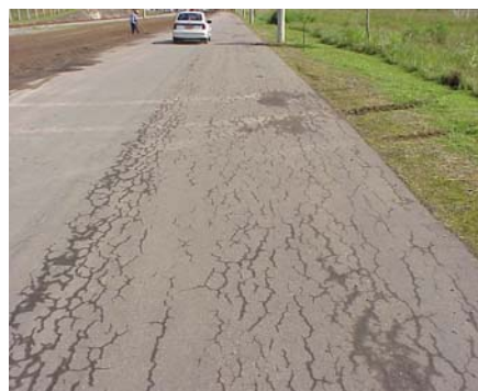
(b) Pavimento trincado
