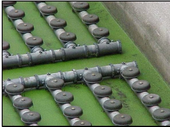
Figura III.2 – Difusores de ar da ETE Norte de Brasília - DF.
