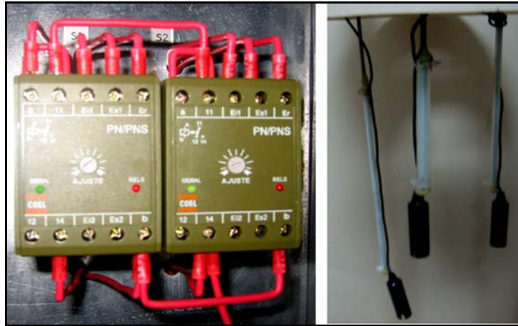
Figura V.9 – Controlador de nível usando eletrodos para controle do nível mínimo e máximo no tanque de aeração.
