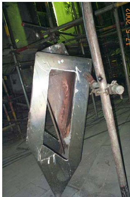
Figura VI.38 – Aberturas na carenagem das válvulas das pernas dos ciclones para diminuir a superfície de arrasto.
