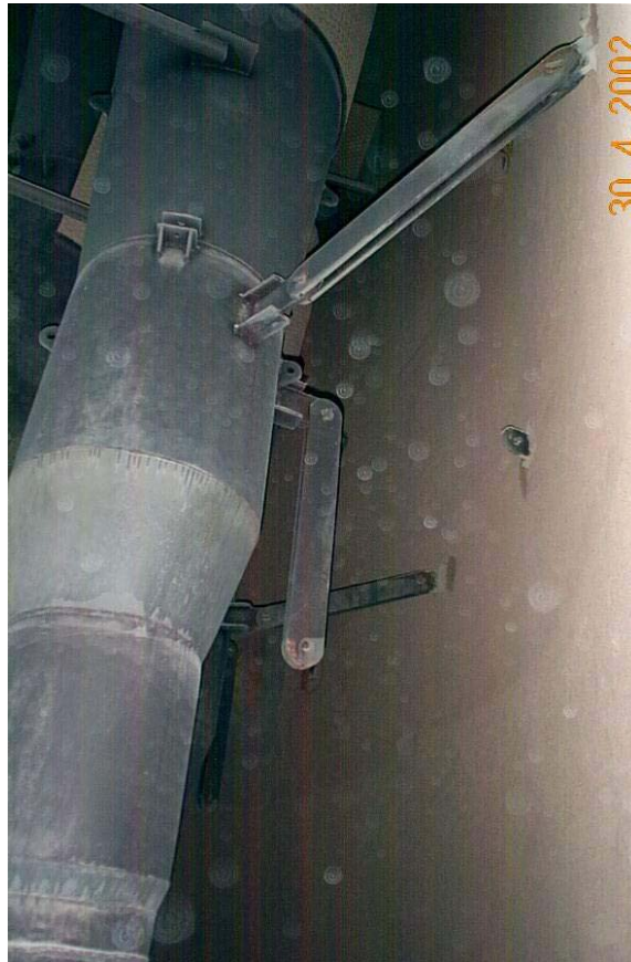
Figura VI.6 – Guias do ciclone de primeiro estágio rompidas.
