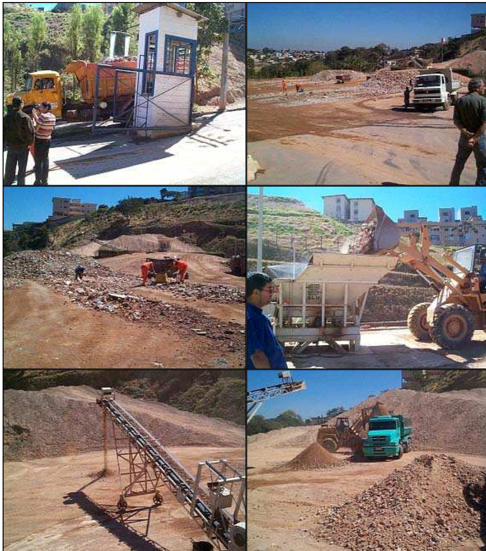
Figura 3.2 - Molhagem do RCD ao chegar na usina; vista geral da área de descarregamento de RCD; pré-triagem do RCD; lançamento de RCD no britador; transporte em esteira com eletroímã dos agregados; carregamento de caminhão com agregados reciclados destinados às obras da PBH. (Fotos do autor, ago/2003).
