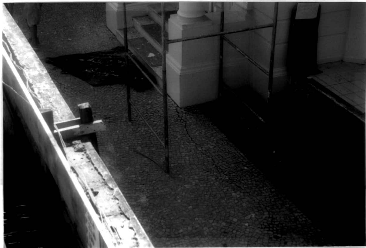
Fotografia 5.3 - Rachadura na calçada da FEMAR
