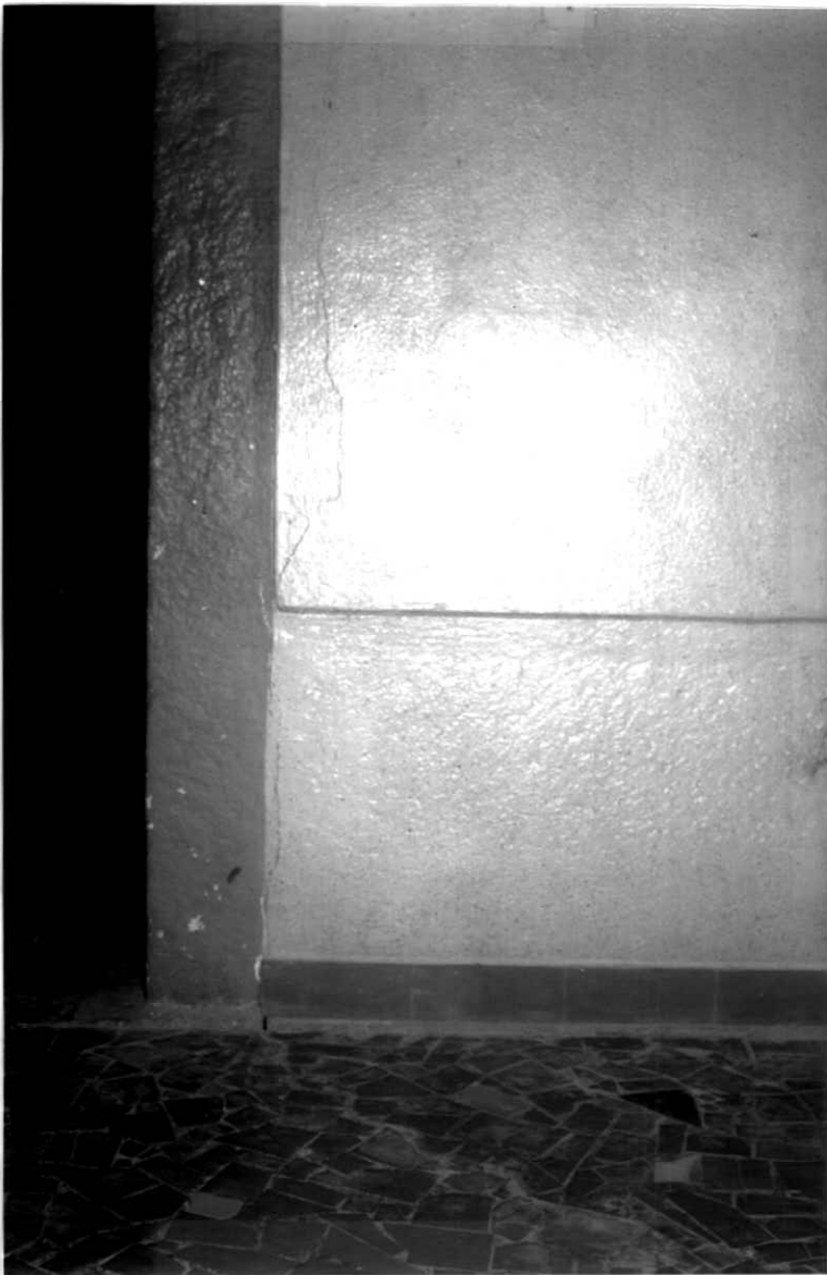
Fotografia 5.1 - Rachadura no Colégio da Imaculada Conceição
