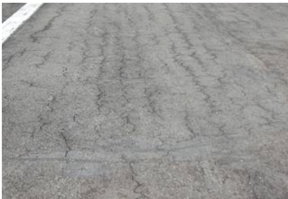
Figura 7.5: Exemplo de dano de fadiga em pavimento asfáltico.
