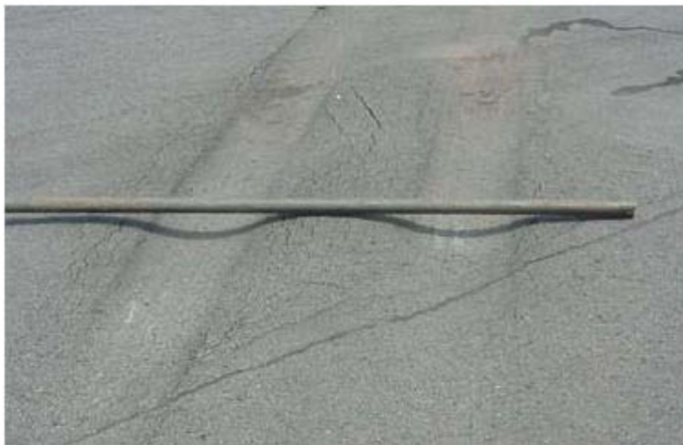
Figura 7.2: Exemplo de deformação permanente em pavimento asfáltico.
