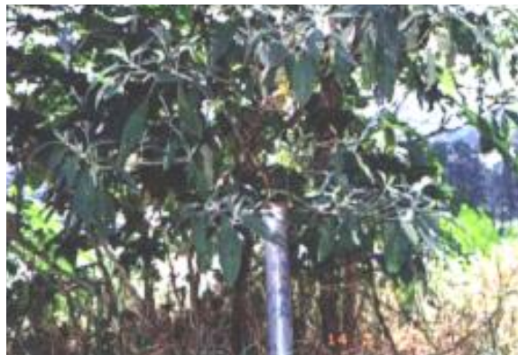
Foto 7 – Planta vegetando sobre dreno de gás
