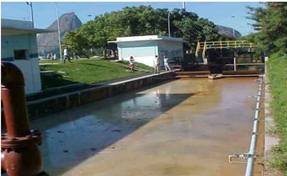
Figura 4.8 - Estação de tratamento na praia do Flamengo
